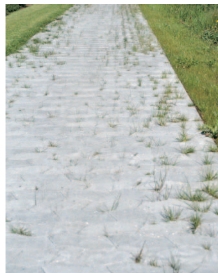
Nye fuger er ofte ikke fyldte og komprimerede, hvilket giver ukrudtet frit spil.
